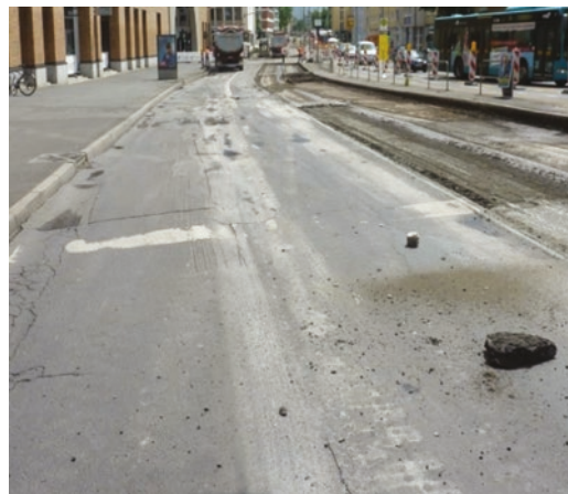
Pavimento a ser fresado
