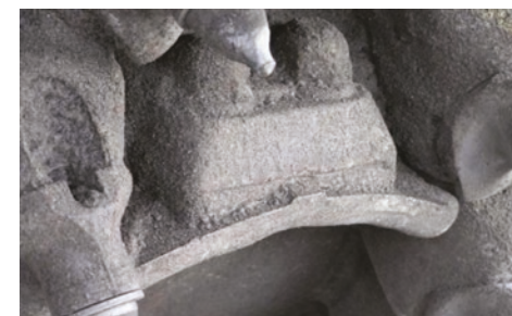
Estado dos ejetores
