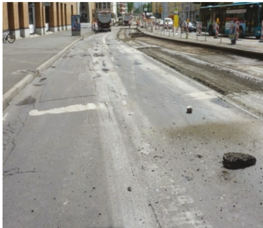
Pavimento a ser fresado
