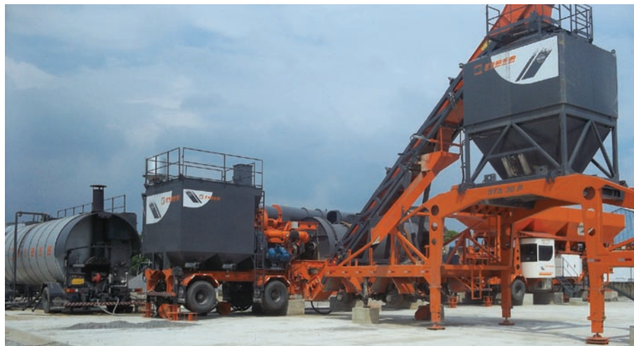
Planta de asfalto Ciber en operación en el municipio de Girardot
