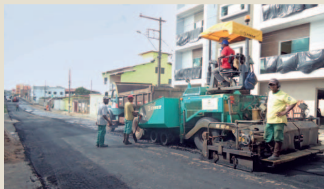
Equipo para operar en 80.000 metros de vías
