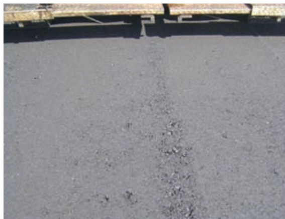
Riesgo central, longitudinal, causado por posicionamiento incorrecto de las aletas inversoras
